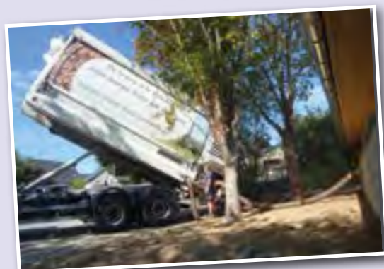
Mise en route du réseau de chaleur qui alimente les bâtiments communaux.
