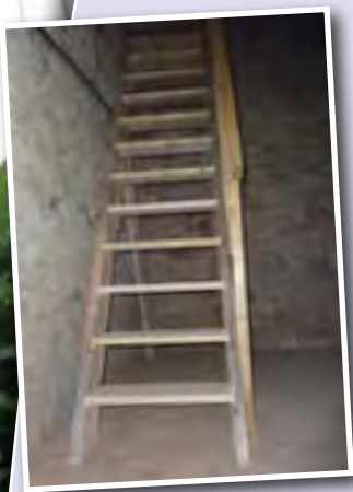
Mise en sécurité du clocher de l'église par l'installation de nouvelles échelles et d'un plancher.
